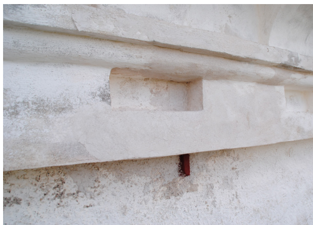
Takgesimsen har putslagats med hydrauliskt kalkbruk.
