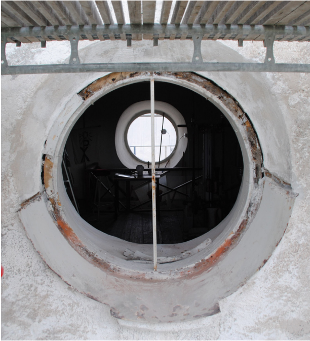
Det runda fönstret i tornet hade en extra ram av trä spikad utanpå karmen. Delar av ramen var rötskadad.
