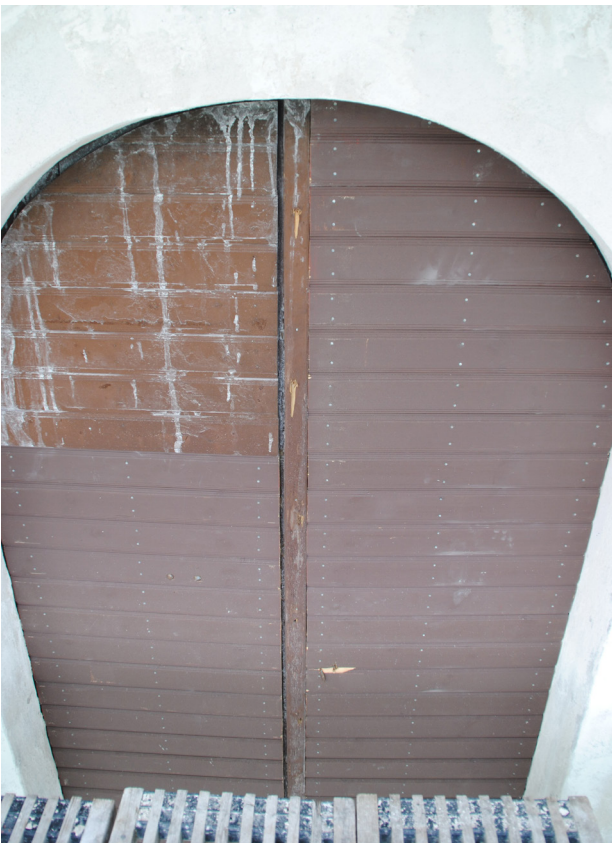
Östra ljudluckan har mycket rötskador och större delen av panelen har bytts ut.
