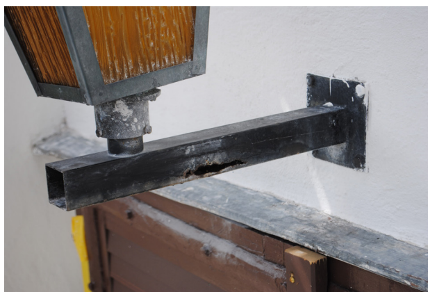
Alla fästen till lamphusen över entréerna hade rostska-dor och hål.
