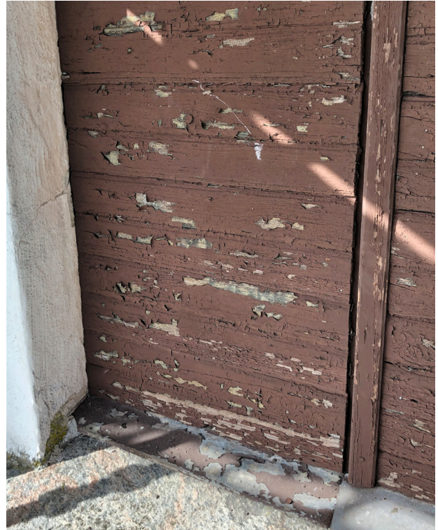
Ljudluckorna var i stort behov av ommålning. När de rengjordes från löst sittande färg fanns det även en hel del rötskador, särskilt på den östra.
