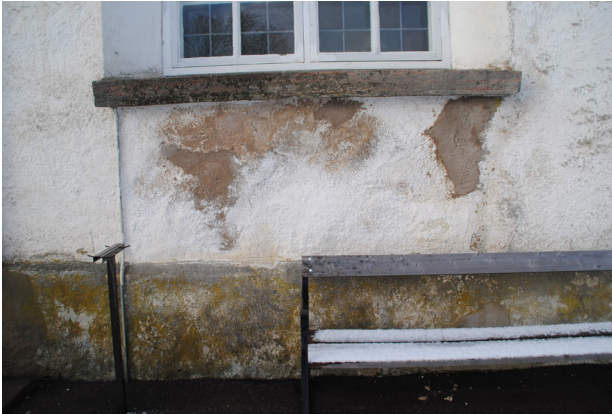
Ovan: Puttskador och lagningar under fönstret på korets södra sida.
