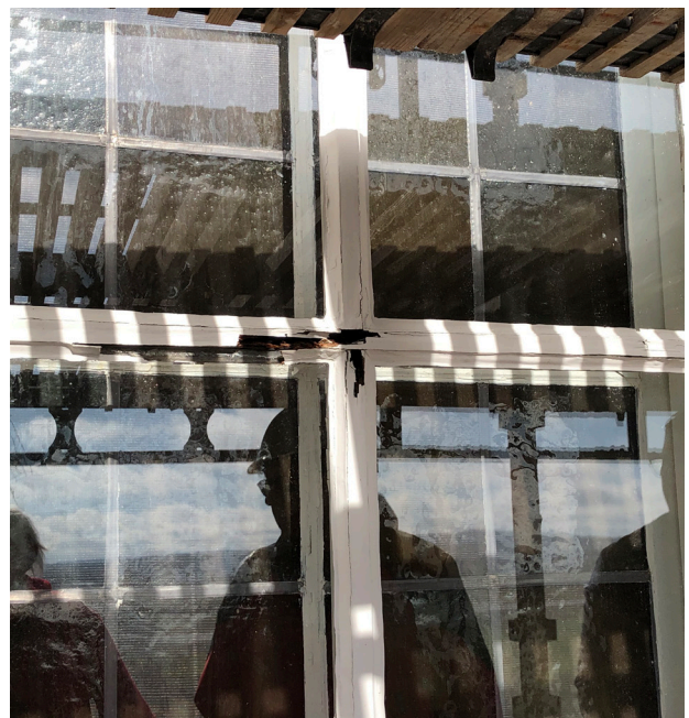
Till vänster och ovan: Kyrkans fönster är troligen ursprungliga och har högt kulturhistoriskt värde. Vid beskiktning före renoveringen såg skicket ut att vara bra, förutom att de behövde ommålning. Färgskiktet, som visade sig vara en modern tät färgtyp, dölde stora rötskador. Den täta färgtypen är troligen orsaken till de stora skadorna.
