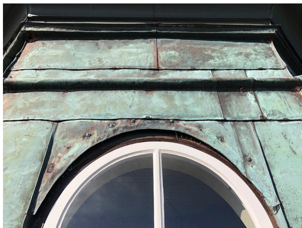
Det finns mycket skador på lanterninväggarnas och tornhuvans kopparbeslagning. Dessa har endast lagats provisoriskt.
