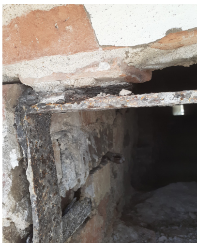
När renoveringen påbörjades upptäcktes att de luckor som finns på tornets takgesims hade stora rostskador på ramarna. Rostskadorna gjorde att puts sprängdes loss.
