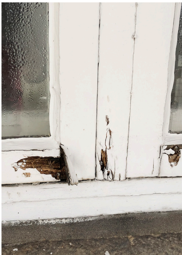
Rötskadorna på fönstren fanns både på bågarna och på karmarna. Bågarna togs ner och renoverades på verkstad.
