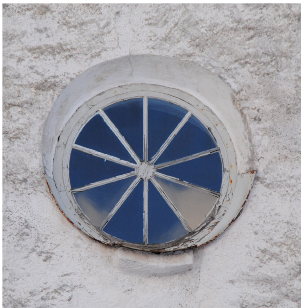
Det runda tornfönstret före renovering. Fönstret hade rötskador både på båge och karm.
