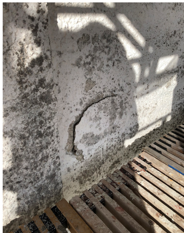
Fasaderna hade äldre lagningar. Olika typer av bruk har använts och en del gamla lagningar hade börjat lossna.
