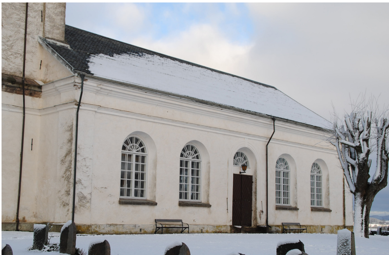
Södra fasaden på långhuset hade påväxt av alger. Sockeln var särskilt angripen och missfärgad. Södra fasadens fönster hade större renoveringsbehov än norrsidan.
