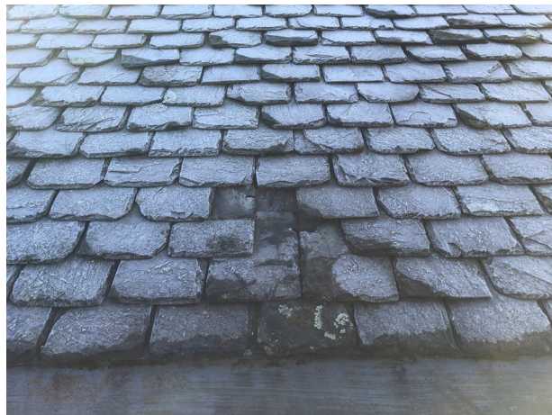
Över hela taken hade enstaka skifferplattor lossnat och trillat ner i ståndrännan.
